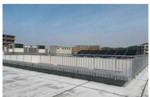
屋上太陽光発電システム
